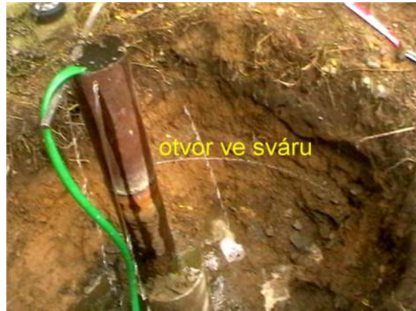
foto 2: Netěsnost sváru ocelové pažnice
