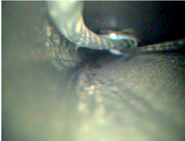
foto 1: Sevření tenkostěnné trubky v hloubce 16 m na šířku silového kabelu (10 mm).
